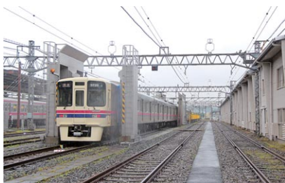
節水型車両洗浄装置
