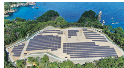
宮古市の発電設備
