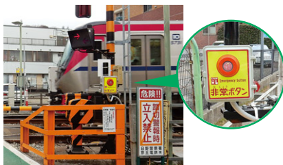
踏切支障報知装置(非常ボタン)
