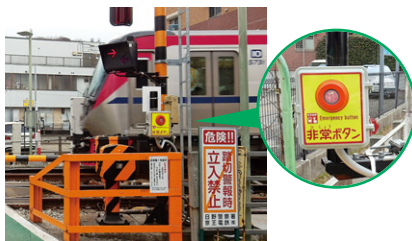
踏切支障報知装置 (非常ボタン)
