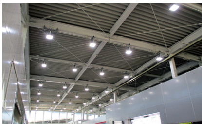
駅構内のLED照明
