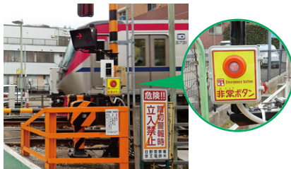
踏切支障報知装置 (非常ボタン)
