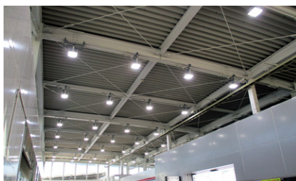
駅構内のLED照明
