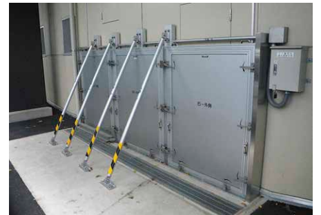
変電所の止水板
