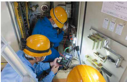
変電所の点検
