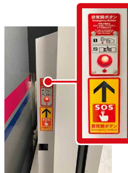
ホームドア非常開ボタン
