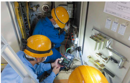
変電所の点検
