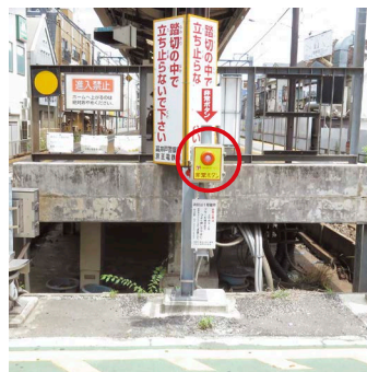
踏切内の踏切支障報知装置 (非常ボタン)
