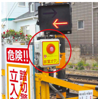
踏切支障報知装置 (非常ボタン)
