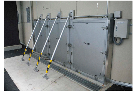
変電所の止水板
