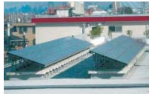
高幡不動産車両基地の太陽光発電システム
