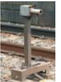
踏切障害物検知装置
