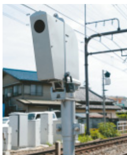
踏切障害物検知装置
