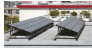
太陽光発電システム
