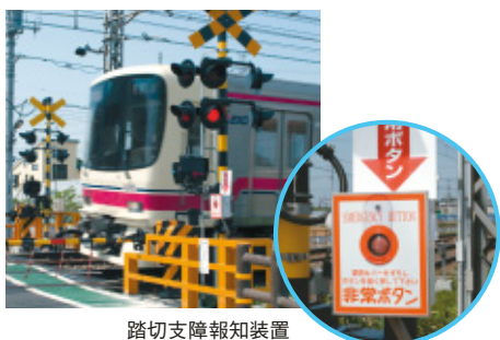
踏切支障報知装置
