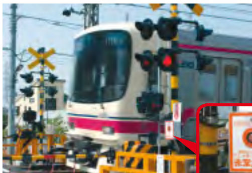
踏切支障報知装置
