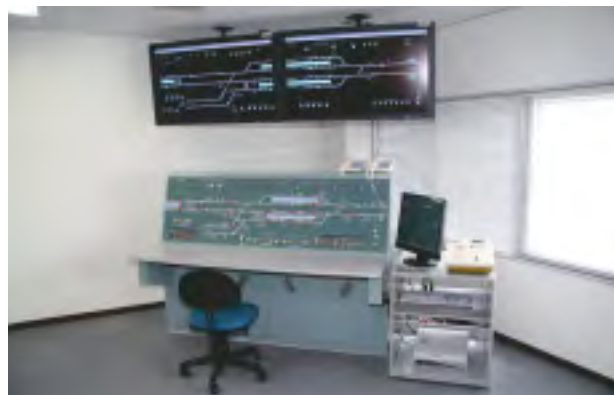
駅係員信号取扱訓練室
