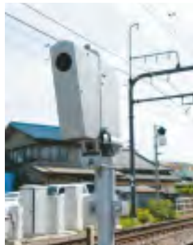
踏切障害物検知装置
