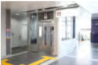
エレベーター
