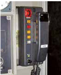
防護無線装置
