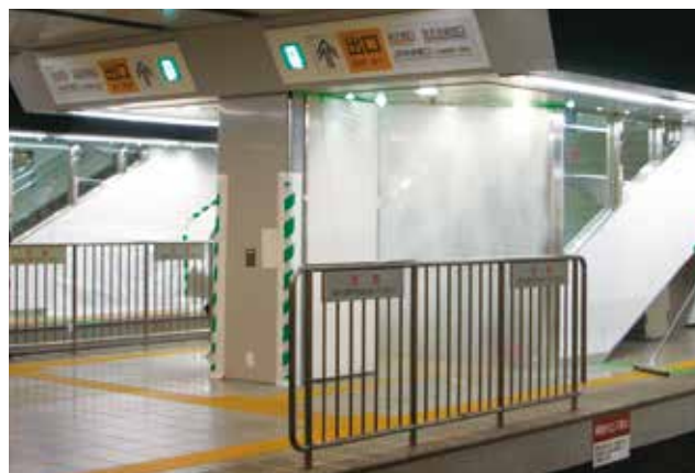
水の幕で防火区画を形成するウォータースクリーン(新宿駅)
