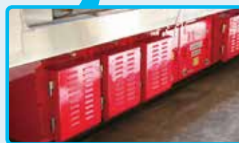
車上蓄電池システムの外観
