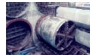
調布駅西側に到達したシールドマシン (調布駅～西調布駅間の上り線が貫通)
