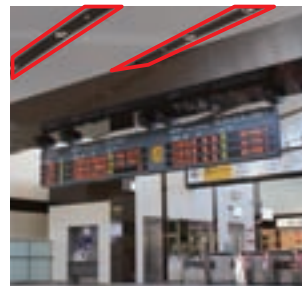
駅構内LED照明 (赤枠内)
