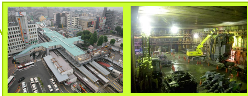
調布駅仮橋上駅舎 (左上) 調布駅の線路下の掘削状況 (右上)
