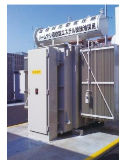
《環境配慮型の変圧器》
